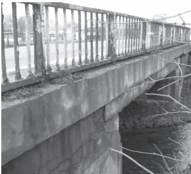
PŮVODNÍ MOSTY byly již v havarijním stavu. Foto Daniel Žídek
